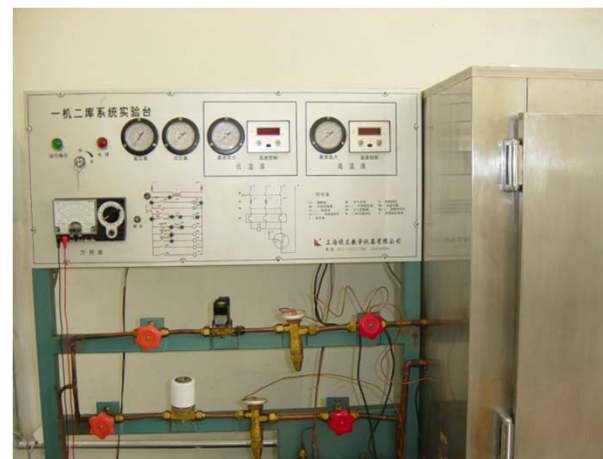
中央空调系统
